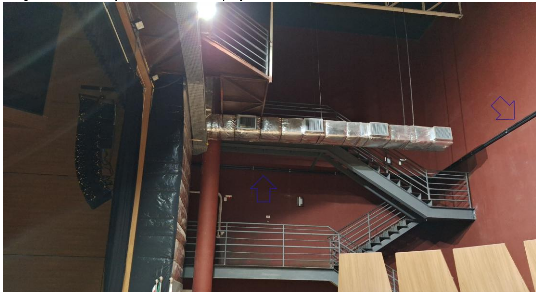
Imagem 10 – Indicação dos cabos dos projetores
