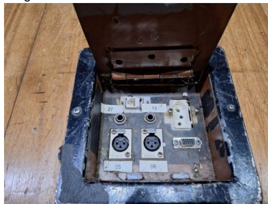
Imagem 12 – Pannel de caixas de conexão
