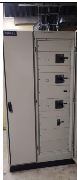
Figura 06: Vista frontal externa do quadro “QNBCPD”, localizado na sala técnica dos nobreaks.
