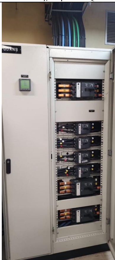
Figura 07: Vista frontal do quadro QDNB na sala de nobreaks existente, localizada no 2º subsolo do Anexo II.
