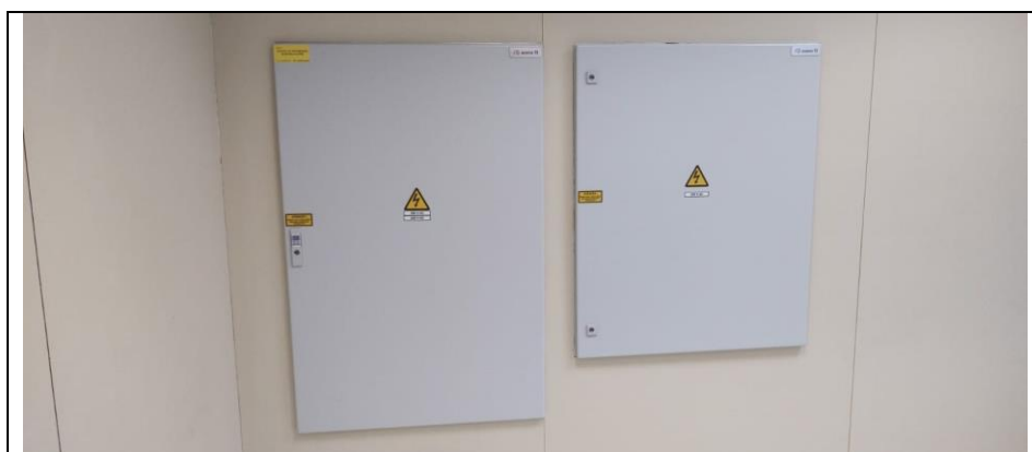
Figura 01: Vista frontal externa do quadro “QDAR-SALA.COFRE” (esquerda) e do Quadro de distribuição da sala cofre (direita), ambos localizados na antecâmara da Sala Cofre.
