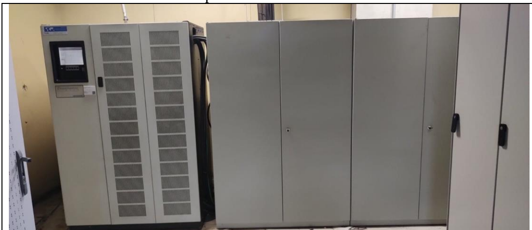
Figura 07: Vista frontal externa do nobreak 03, responsável pela alimentação das cargas de energia estabilizada (computadores) do Anexo II.
