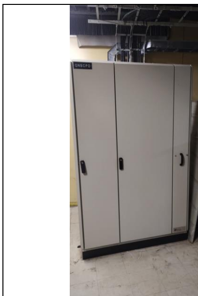
Figura 05: Vista frontal externa do quadro “QNBCPD”, localizado na sala técnica dos nobreaks.
