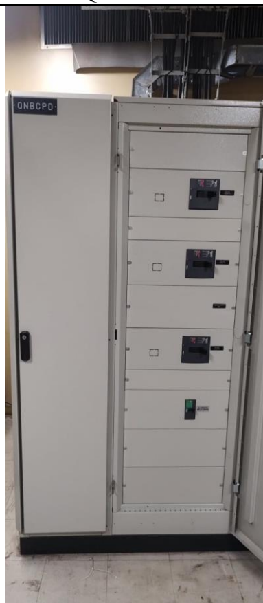
Figura 08: Vista frontal do quadro QCNPDP na sala de nobreaks existente, localizada no 2º subsolo do Anexo II.
