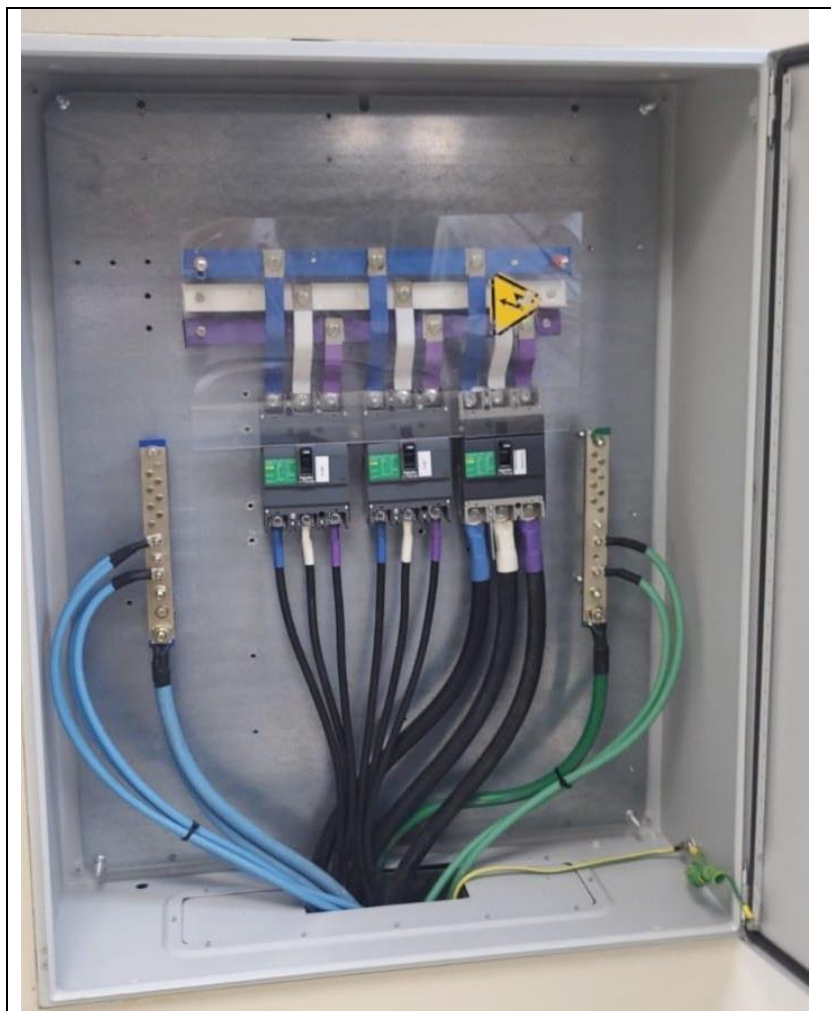
Figura 02: Vista frontal interna do quadro de distribuição da sala cofre, localizado em sua antecâmara.
