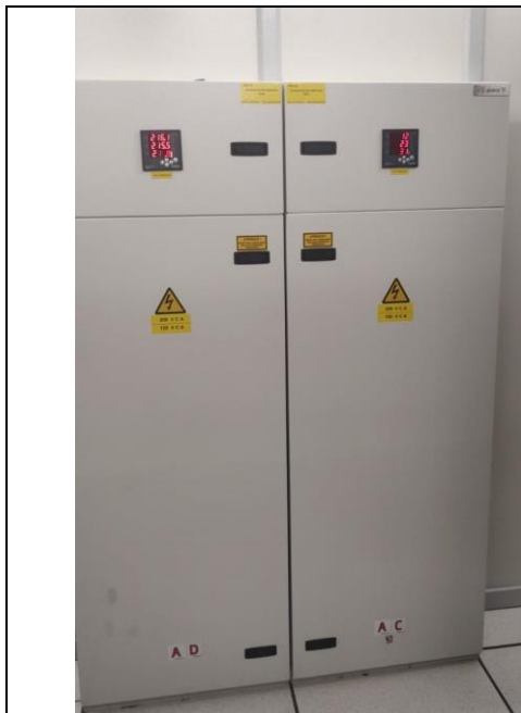
Figura 03: Vista frontal externa dos quadros “QDIX e QDIY”, localizados no interior da Sala Cofre.
