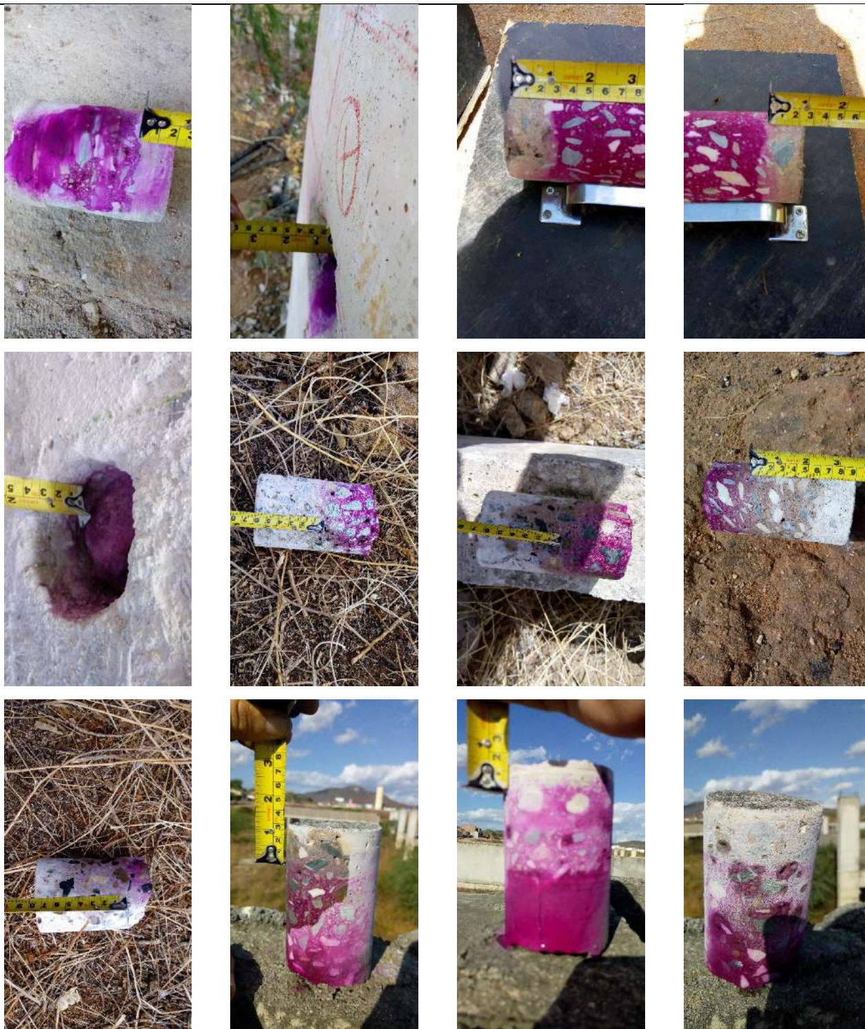
Fotografias n.º 646 a 657 – ensaio de profundidade de carbonatação T33, T34, T38, T39, T41, T59, T60, T61, T62, T64, T65, T66, respectivamente.
