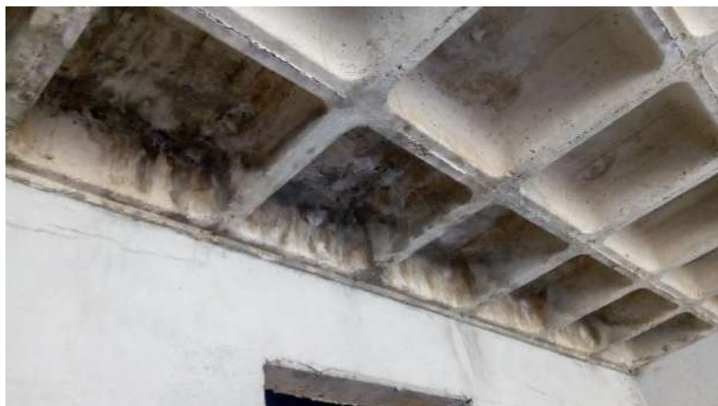
Fotografia n.º 747 – fissuras devido ao cisalhamento.
