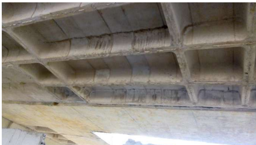
Fotografia n.º 720 – indicando a posição das fissuras em relação a viga V6
