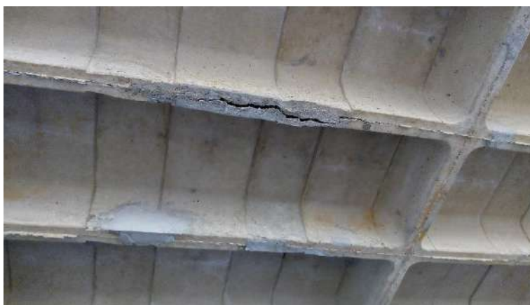
Imagem n.º 722 – rachadura recorrente na face inferior da nervura nas lajes.
