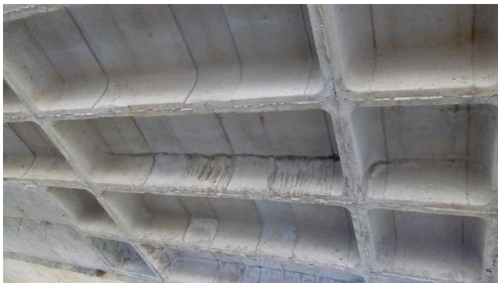
Fotografias n.º 717 e 718 – indicando a posição das fissuras em relação a viga V6
