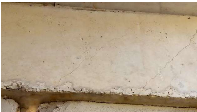
Fotografia n.º 733 – fissuras devido a torção.
