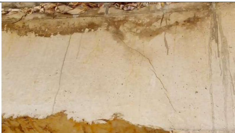
Fotografia n.º 735 – fissuras devido ao cisalhamento.
