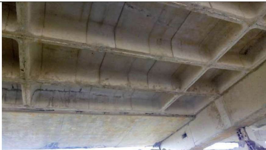
Fotografia n.º 719 – indicando a posição das fissuras em relação a viga V6
