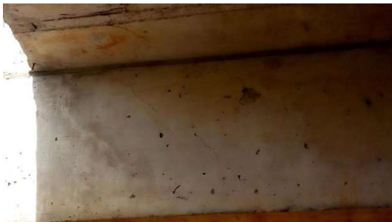
Fotografia n.º 731 – fissuras devido a torção.
