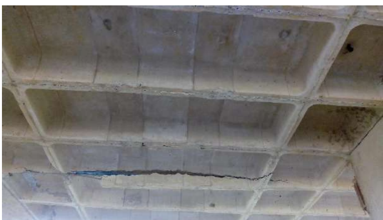
Imagem n.º 727 – rachadura recorrente na face inferior da nervura nas lajes.
