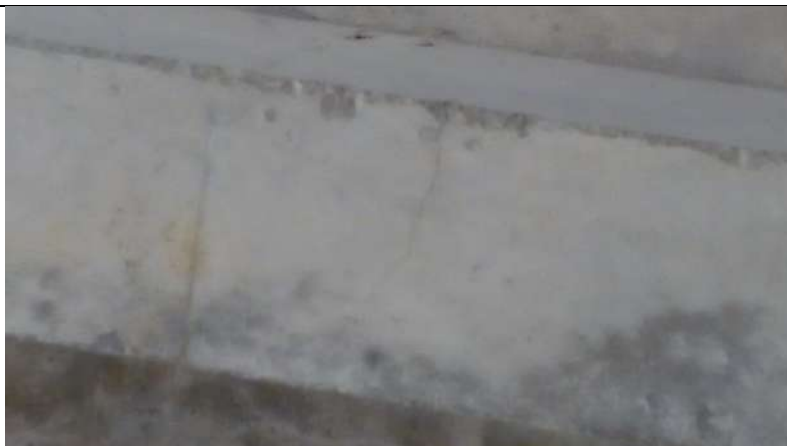
Fotografia n.º 748 – fissuras a flexão.
