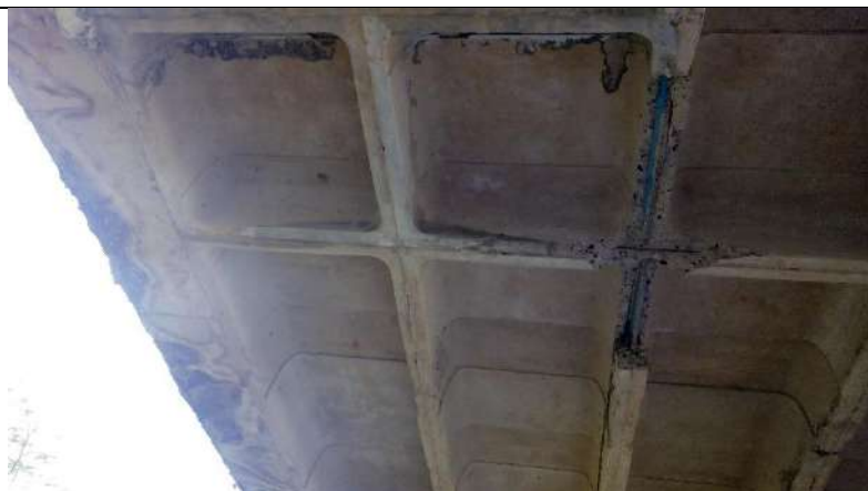
Imagem n.º 726 – rachadura recorrente na face inferior da nervura nas lajes.
