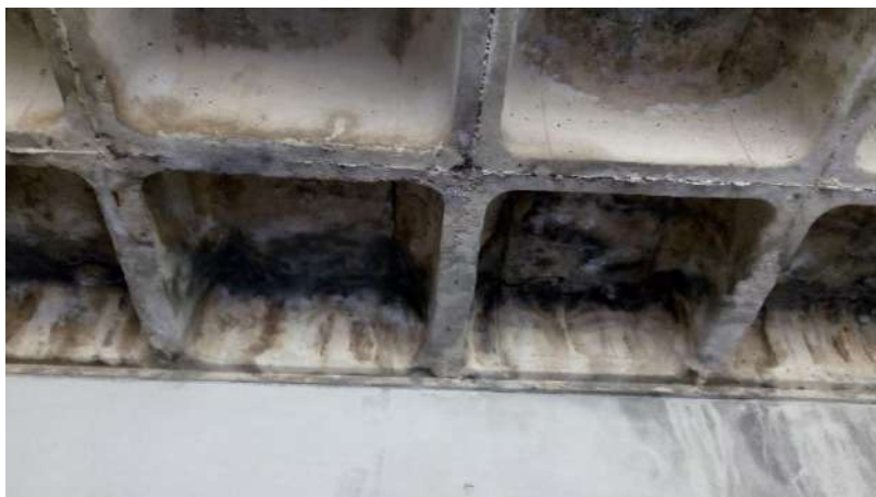
Fotografia n.º 745 – fissuras devido ao cisalhamento.
