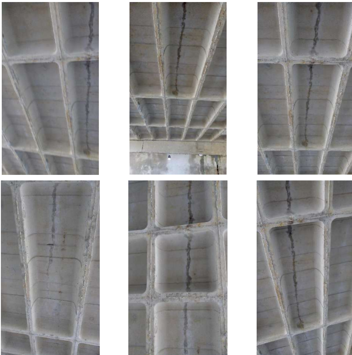
Fotografias nº 701, 702, 703, 704, 705 e 706 – trincas nas faces inferior das lajes.
