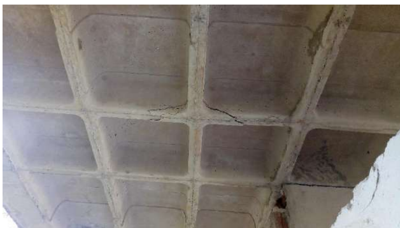
Imagem n.º 725 – rachadura recorrente na face inferior da nervura nas lajes.
