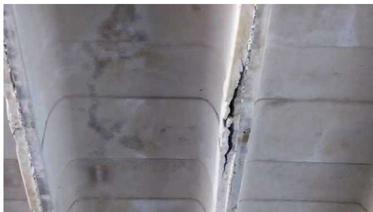
Imagem n.º 723 – rachadura recorrente na face inferior da nervura nas lajes.
