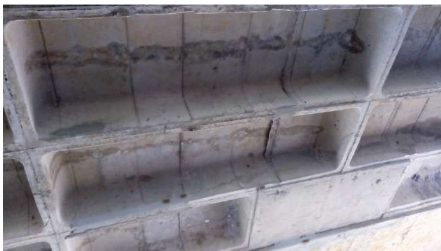
Fotografia n.º 721 – indicando a posição das fissuras em relação a viga V6
