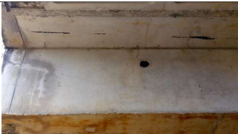
Fotografia n.º 732 – fissuras devido a torção.
