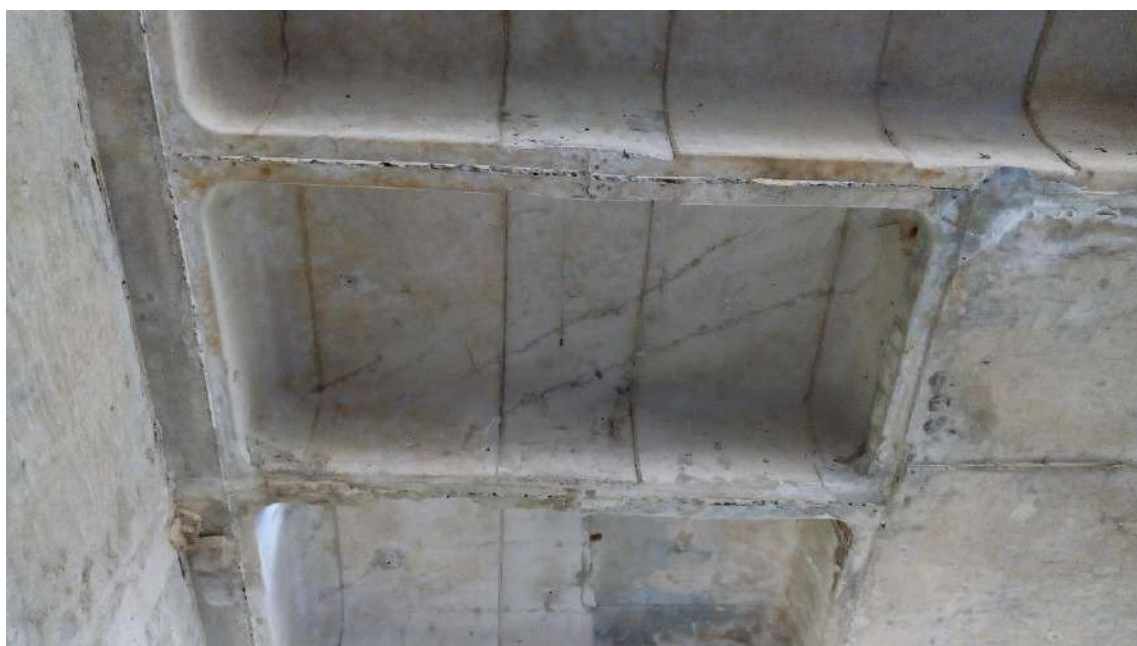
Fotografia n.º 714 – indicando a posição das fissuras
