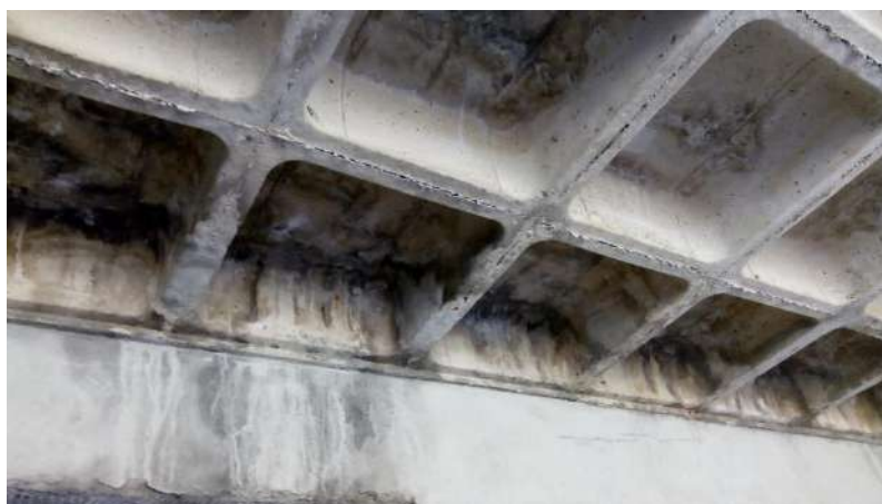
Fotografia n.º 746 – fissuras devido ao cisalhamento.
