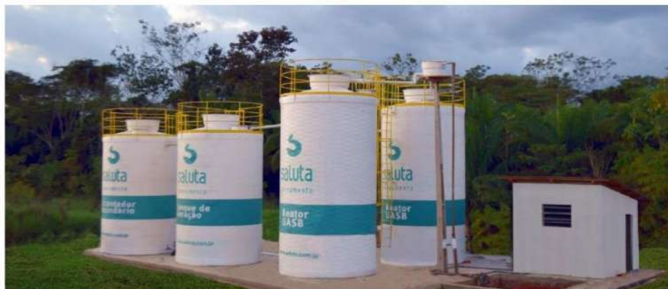
Vazão: 213.000 Litros/ dia ou 2,46 Litros/Segundo. Cliente: Abaco Engenharia Ltda Local: Rio Branco - AC
