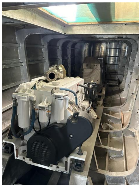
Verificação da praça de máquina (motor e gerador instalado).
