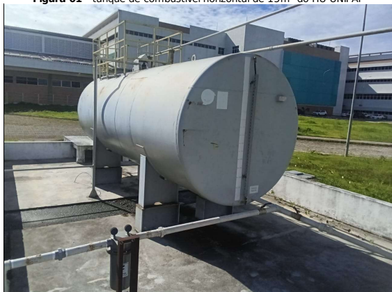
Figura 01 - tanque de combustível horizontal de 15m³ do HU-UNIFAP
