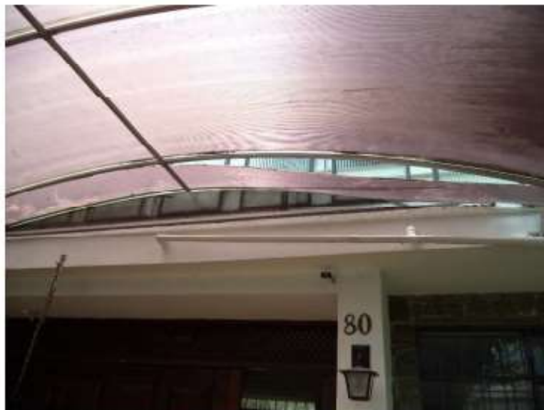
Fotografia 04 – Cobertura de policarbonato da garagem danificada.
