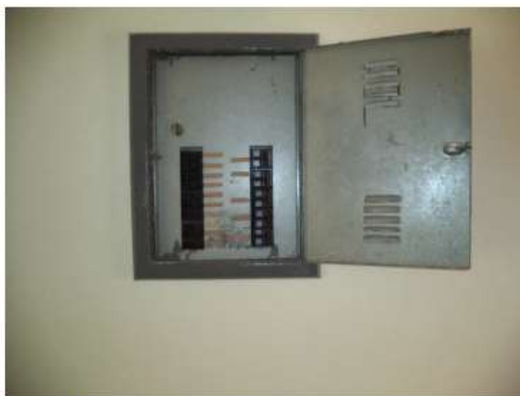
Fotografia 08 – Quadro de força no pavimento térreo.
