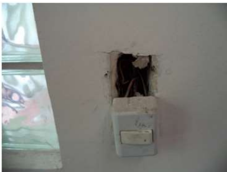
Fotografia 28 – Interruptor danificado na sala da segunda edificação.
