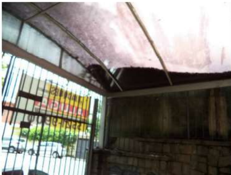
Fotografia 05 – Cobertura de policarbonato da garagem com folhas.
