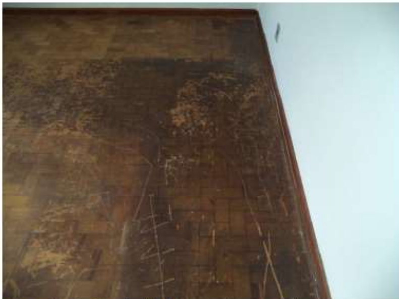
Fotografia 23 – Piso danificado no pavimento superior.
