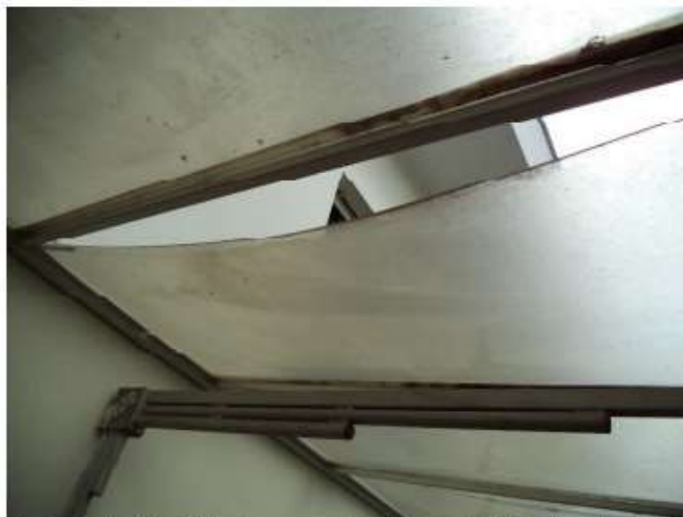
Fotografia 15 – Cobertura em policarbonato danificada na lateral esquerda do imóvel.
