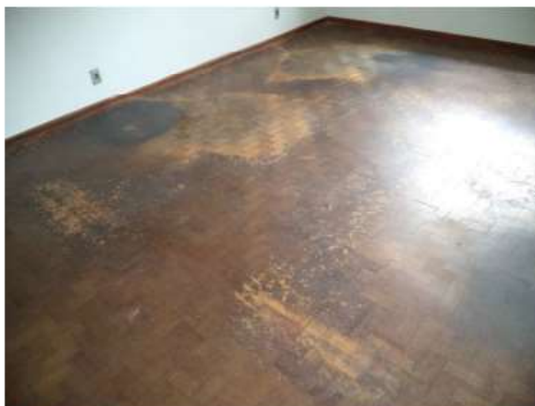
Fotografia 24 – Piso danificado no pavimento superior.
