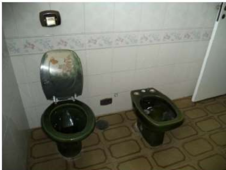
Fotografia 25 – Tamba do vaso sanitário danificada no pavimento superior.
