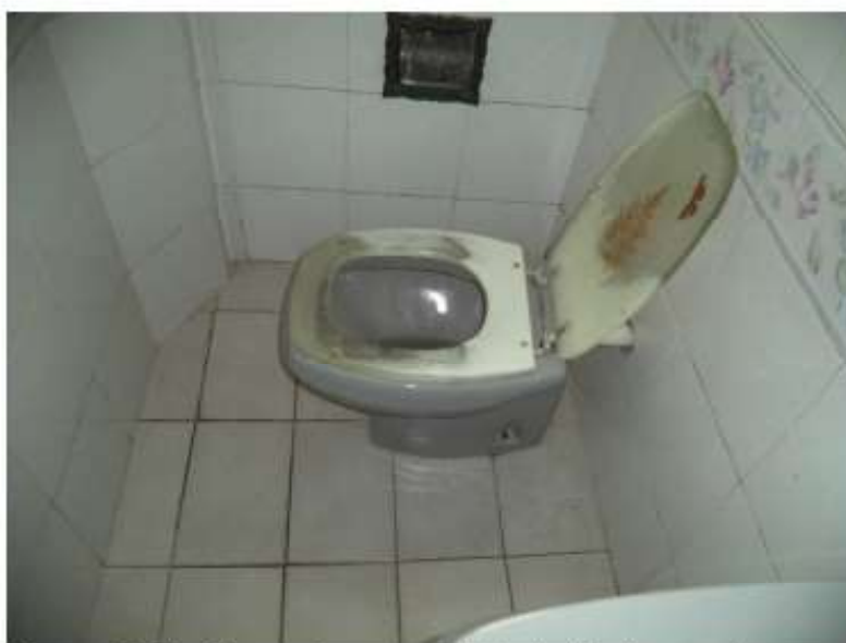
Fotografia 10 – Tampa do vaso sanitário danificada no pavimento térreo.
