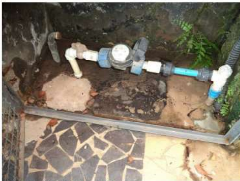
Fotografia 03 – Hidrômetro de água.
