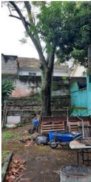
Figura 30 – Árvore muro vizinho
