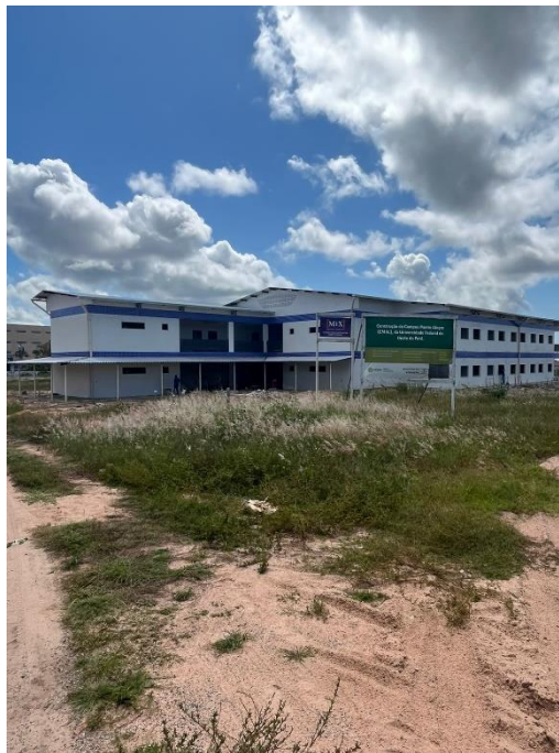
Figura 6 - Fachada Posterior da Edificação de Núcleo de Salas construído no Campus Monte Alegre - UFOPA
