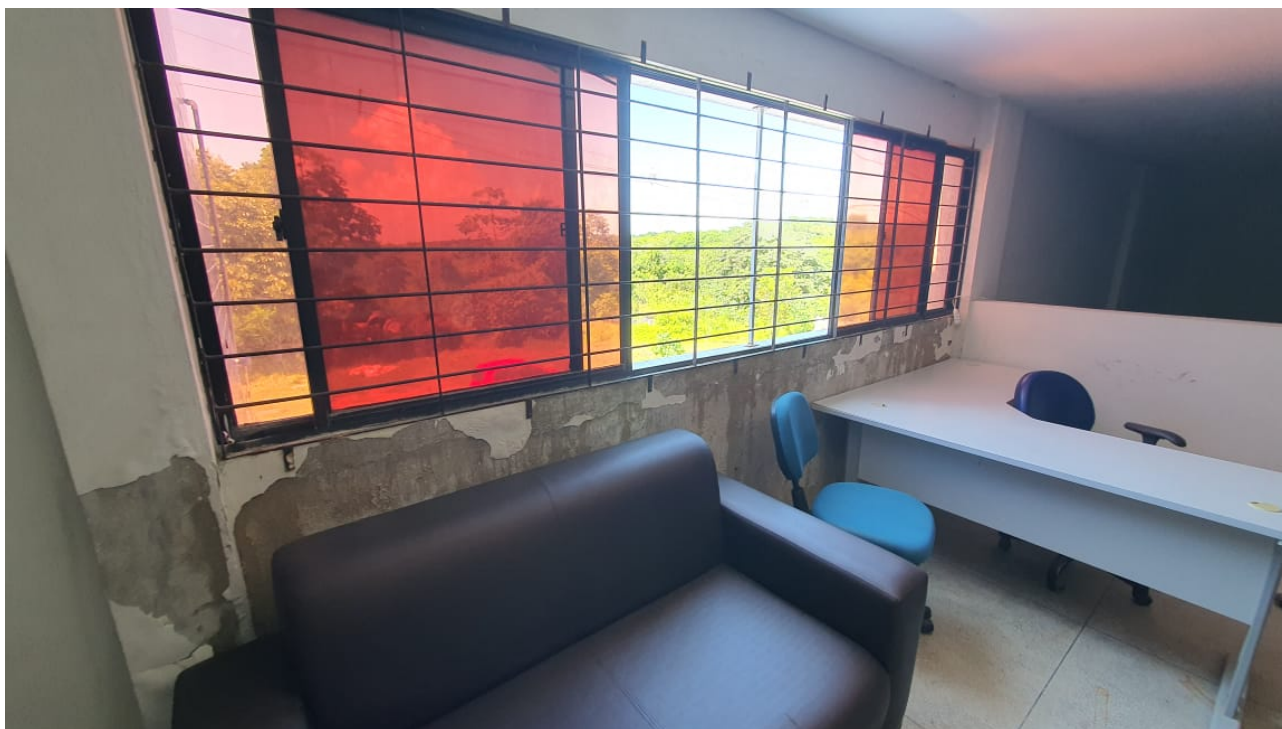
Foto 09: Ambiente interno pendente de adequação.
