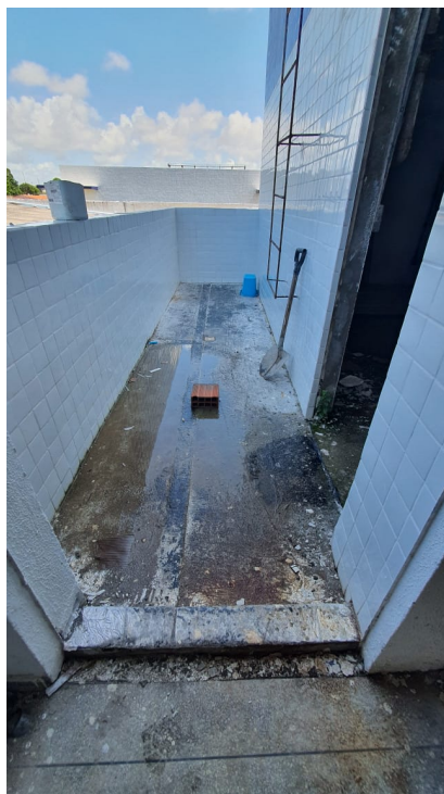
Foto 05: Problema de acúmulo de água na parte interna da obra.
