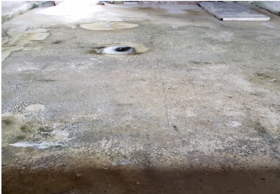
Deterioração 05: Piso danificado;
