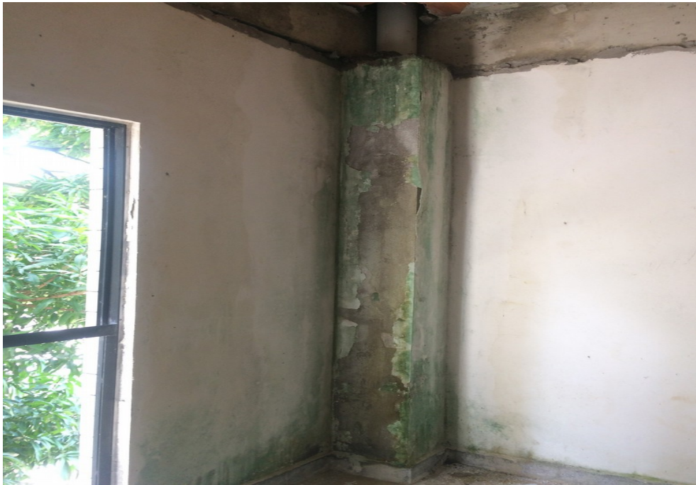
Deterioração 15: Coluna danificada;
