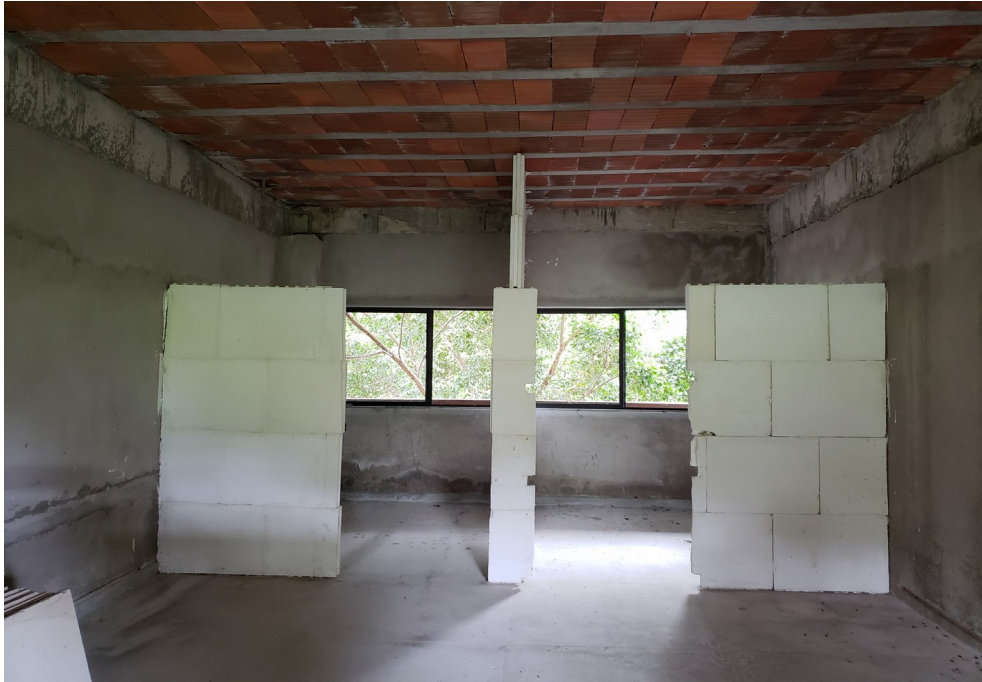
Deterioração 04: Parede inacabada;
