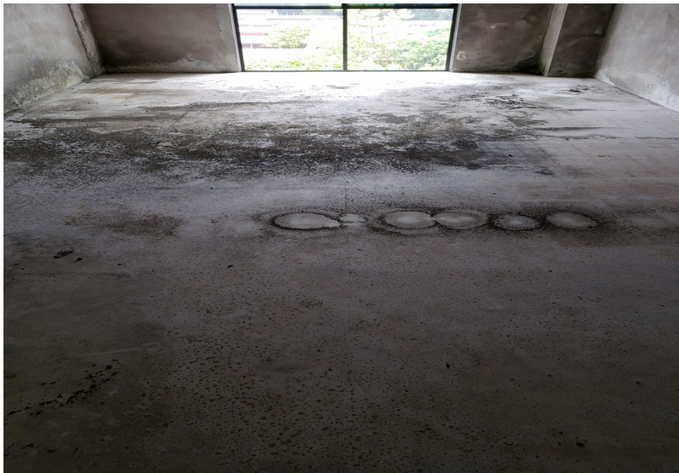
Deterioração 07: Piso danificado; Deterioração 08: Coluna danificada;
