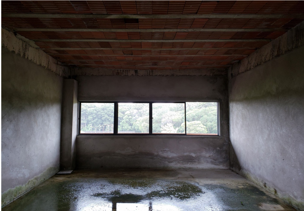
Deterioração 06: Piso danificado;
