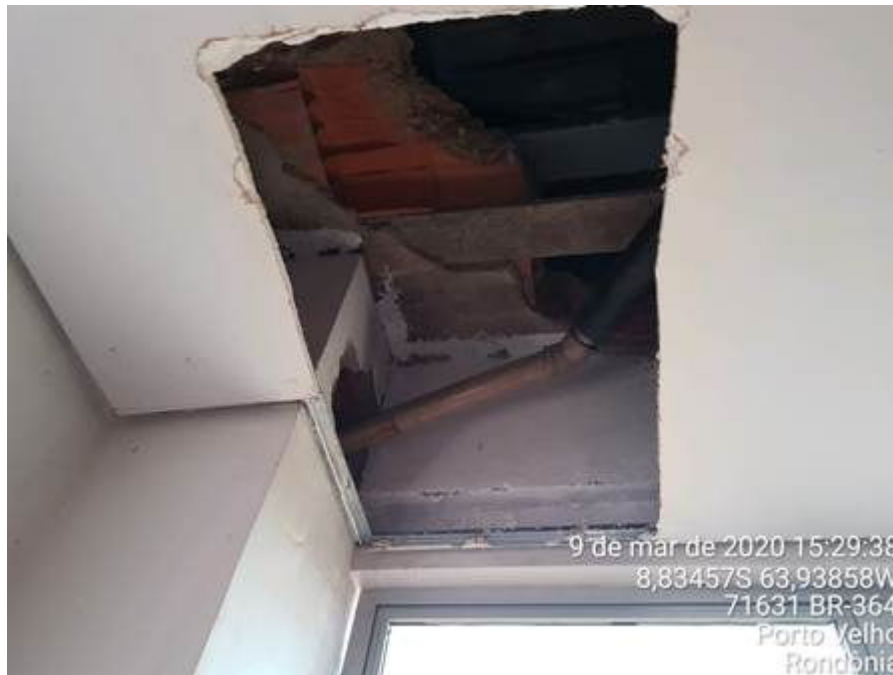
Instalações do Dreno (Parte s/Isolamento) devido a ação de terceiros
