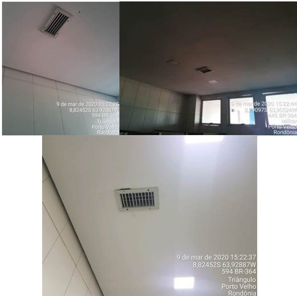
Dutos e Grelhas de Exaustão Instalados
