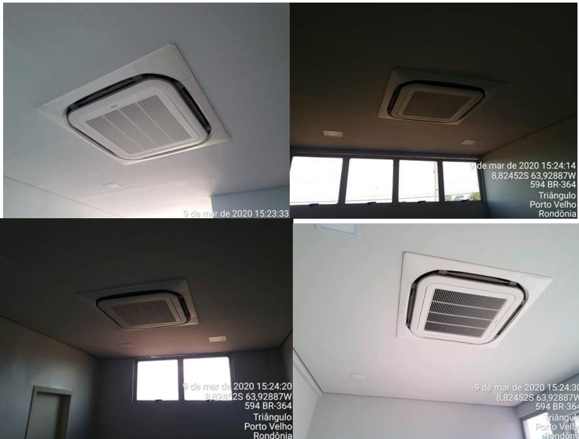
Instalações das Evaporadora Cassete 4 Vias
