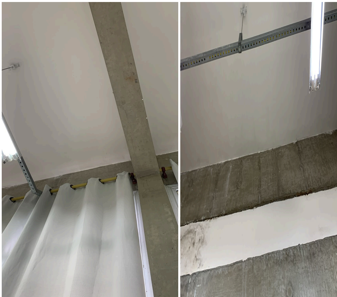
Foto 02 – Necessidade de mais uma demão de pintura no teto da biblioteca.
