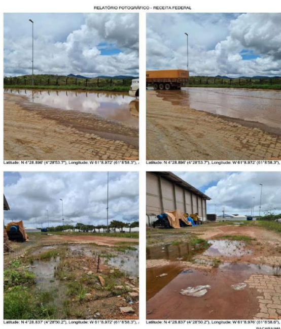
Imagem 1 - Imagens com demonstração de acúmulo de água e deterioração de pavimento da IRF
