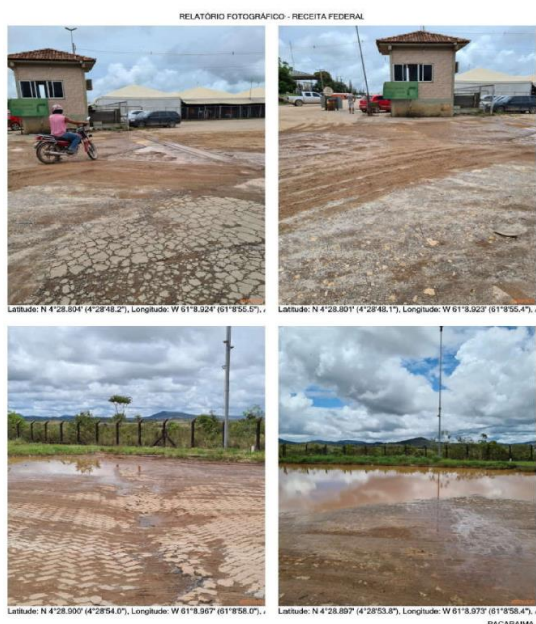
Imagem 2 - Pavimento deteriorado da IRF
