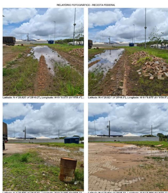
Imagem 3 - Pavimento deteriorado com acúmulo de água com áreas inservíveis
