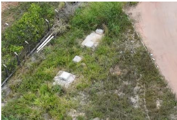
Imagem 17 - Sistema de Saneamento (Tampas da Fossa/Filtro e Caixas de Inspeção)
