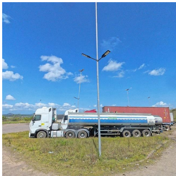
Imagem 14 - Iluminação Externa (Luminárias Solares nos postes)
