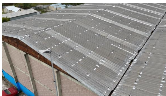
Imagem 15 - SPDA instalado no DMA
