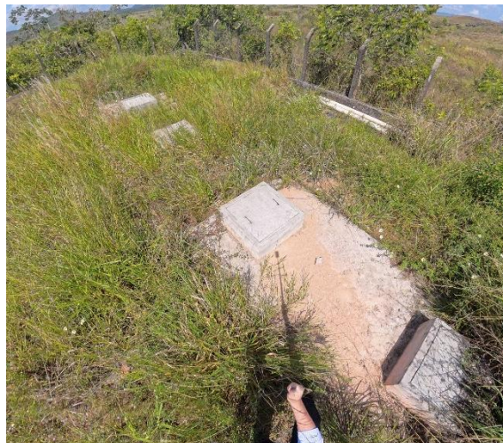
Imagem 19 - Sistema de Saneamento (Tampas da Fossa/Filtro e Caixas de Inspeção)
