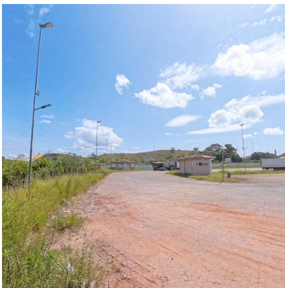
Imagem 13 - Iluminação Externa (Luminárias Solares nos postes)
