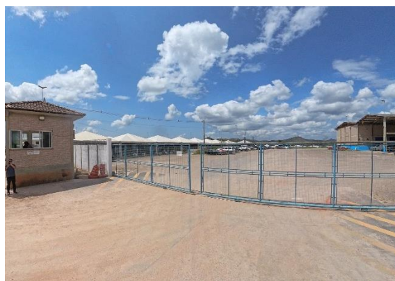
Imagem 11 - Portão de acesso veicular instalado
