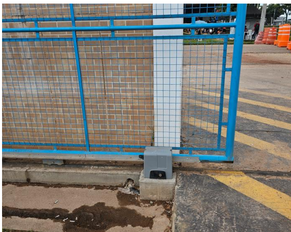
Imagem 12 - Portão de acesso veicular com detalhe no motor instalado
